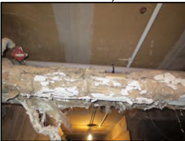
Photo N° 134 ECH-N°2 CALORIFUGEAGE S.sol Conduits de fluide Laine minérale + enveloppe plâtrée
