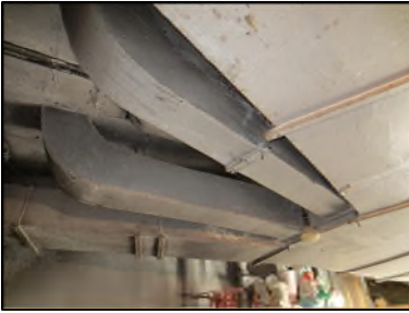
Photo N° 121 AMIANTE CIMENT Atelier 3__RDC Gainés & coffres horizontaux Ventilation haute (Fibres- ciment)
