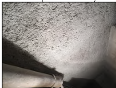
Photo N° 32 ECH-N°1 FLOCAGE Sous sol Plafonds Cotonneux blanc
