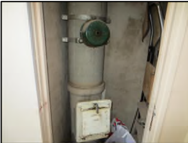
Photo N° 130 AMIANTE CIMENT -- Palier 4 Vide-ordures Gaine V.O.(Fibres-ciment)
