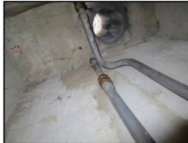
Photo N° 133 AMIANTE CIMENT -- Palier 4- Gaine technique Conduits de VENTILATION Ventilation haute (Fibres-ciment)
