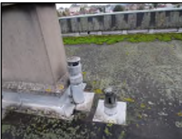
Photo N° 135 AMIANTE CIMENT -- Toiture Conduits Ventilation basse (Fibres-ciment)
