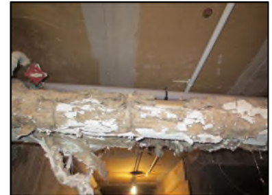
Photo N° 134 ECH-N°2 CALORIFUGEAGE Sous sol Conduits de fluide Laine minérale + enveloppe plâtrée
