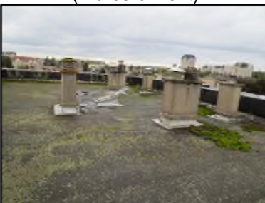
Photo N° 141 ECH-N°3 AMIANTE CIMENT --Toiture Planchers Bitume noir
