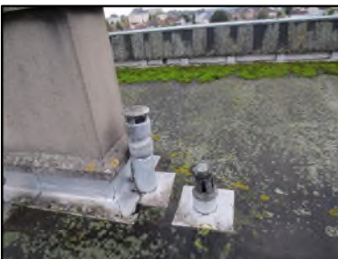
Photo N° 135 AMIANTE CIMENT -- Toiture Conduits Ventilation basse (Fibres-ciment)
