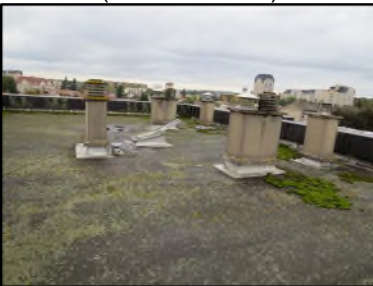
Photo N° 141 ECH-N°3 AMIANTE CIMENT --Toiture Planchers Bitume noir
