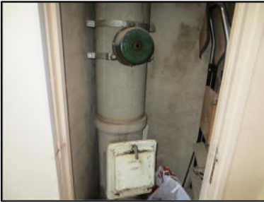
Photo N° 130 AMIANTE CIMENT -- Palier 4 Vide-ordures Gaine V.O.(Fibres-ciment)
