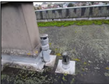
Photo N° 135 AMIANTE CIMENT -- Toiture Conduits Ventilation basse (Fibres-ciment)
