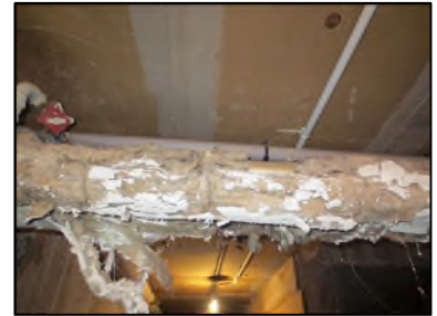
Photo N° 134 ECH-N°2 CALORIFUGEAGE Sous sol Conduits de fluide Laine minérale + enveloppe plâtrée
