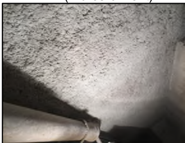
Photo N° 32 ECH-N°1 FLOCAGE Sous sol Plafonds Cotonneux blanc
