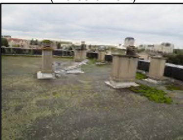
Photo N° 141 ECH-N°3 AMIANTE CIMENT --Toiture Planchers Bitume noir
