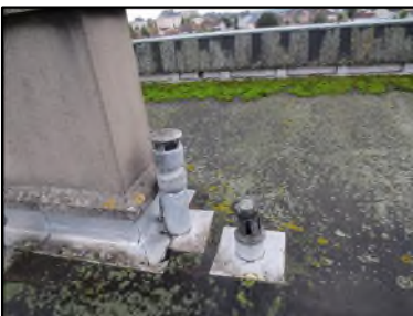
Photo N° 135 AMIANTE CIMENT -- Toiture Conduits Ventilation basse (Fibres-ciment)
