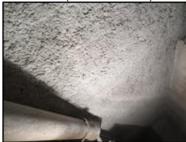
Photo N° 32 ECH-N°1 FLOCAGE Sous sol Plafonds Cotonneux blanc
