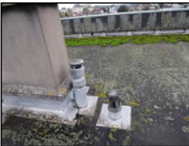
Photo N° 135 AMIANTE CIMENT -- Toiture Conduits Ventilation basse (Fibres-ciment)
