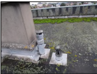
Photo N° 135 AMIANTE CIMENT -- Toiture Conduits Ventilation basse (Fibres-ciment)
