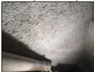
Photo N° 32 ECH-N°1 FLOCAGE Sous sol Plafonds Cotonneux blanc
