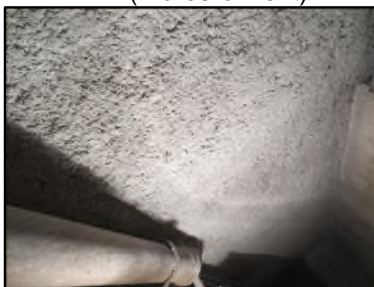
Photo N° 32 ECH-N°1 FLOCAGE Sous sol Plafonds Cotonneux blanc
