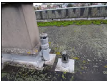
Photo N° 135 AMIANTE CIMENT -- Toiture Conduits Ventilation basse (Fibres-ciment)
