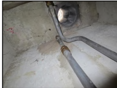
Photo N° 133 AMIANTE CIMENT -- Palier 4- Gaine technique Conduits de VENTILATION Ventilation haute (Fibres-ciment)
