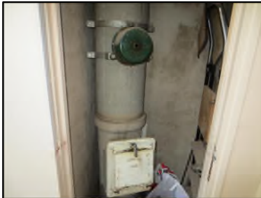
Photo N° 130 AMIANTE CIMENT -- Palier 4 Vide-ordures Gaine V.O.(Fibres-ciment)
