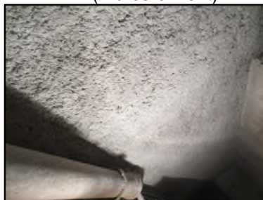
Photo N° 32 ECH-N°1 FLOCAGE Sous sol Plafonds Cotonneux blanc
