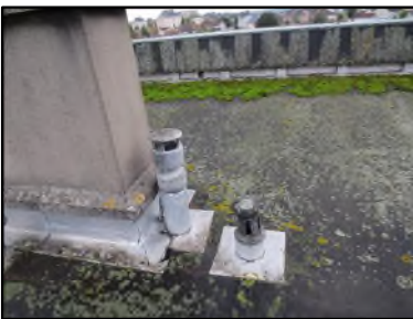
Photo N° 135 AMIANTE CIMENT -- Toiture Conduits Ventilation basse (Fibres-ciment)
