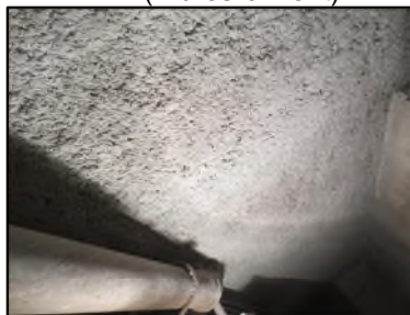
Photo N° 32 ECH-N°1 FLOCAGE Sous sol Plafonds Cotonneux blanc
