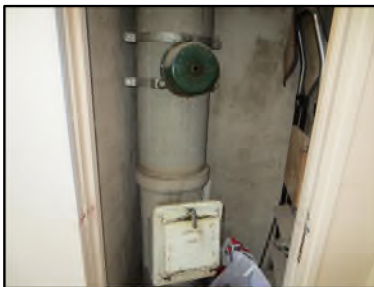
Photo N° 130 AMIANTE CIMENT -- Palier 4 Vide-ordures Gaine V.O. (Fibres-ciment)
