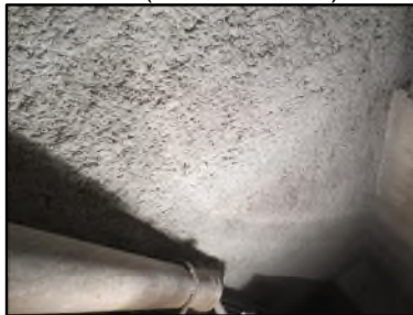
Photo N° 32 ECH-N°1 FLOCAGE Sous sol Plafonds Cotonneux blanc
