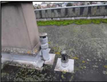
Photo N° 135 AMIANTE CIMENT -- Toiture Conduits Ventilation basse (Fibres-ciment)
