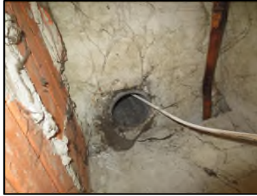
Photo N° 675 AMIANTE CIMENT -- GAINE TECHNIQUE - 4 Conduits de fluide Ventilation haute (Fibres- ciment)
