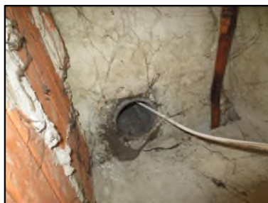
Photo N° 675 AMIANTE CIMENT -- GAINE TECHNIQUE - 4 Conduits de fluide Ventilation haute (Fibres- ciment)
