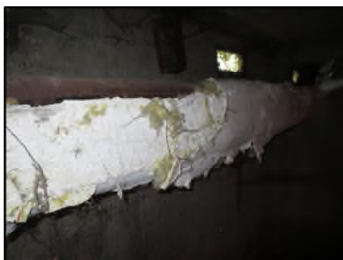
Photo N° 674 ECH-N°1 CALORIFUGEAGE --COULOIR DE CAVE Conduits de fluide Laine minérale + enveloppe plâtrée
