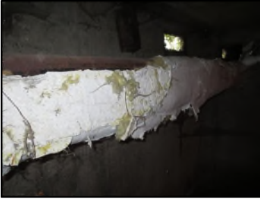
Photo N° 674 ECH-N°1 CALORIFUGEAGE --COULOIR DE CAVE Conduits de fluide Laine minérale + enveloppe plâtrée
