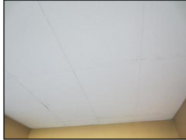
Photo N° 962 AMIANTE CIMENT -- HALL EXTERIEURE Plaques planes (Fibres-ciment)
