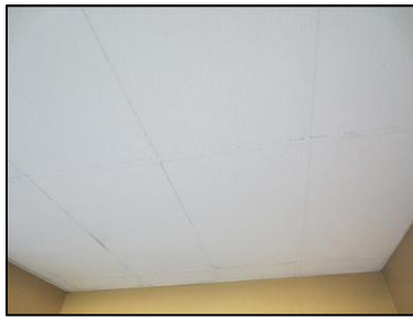
Photo N° 962 AMIANTE CIMENT -- HALL EXTERIEURE Plaques planes (Fibres-ciment)
