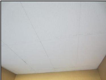
Photo N° 962 AMIANTE CIMENT -- HALL EXTERIEURE Plaques planes (Fibres-ciment)
