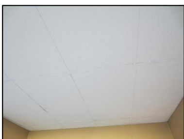
Photo N° 962 AMIANTE CIMENT -- HALL EXTERIEURE Plaques planes (Fibres-ciment)
