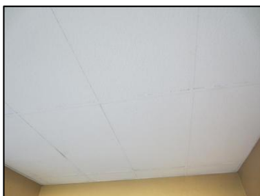
Photo N° 962 AMIANTE CIMENT -- HALL EXTERIEURE Plaques planes (Fibres-ciment)
