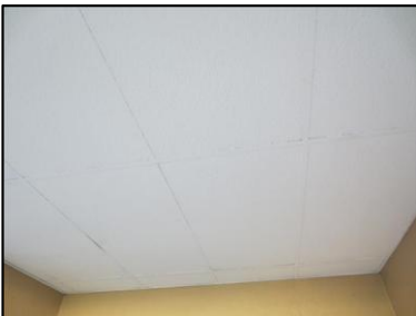
Photo N° 962 AMIANTE CIMENT -- HALL EXTERIEURE Plaques planes (Fibres-ciment)
