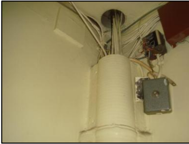
Photo N° 5933 AMIANTE CIMENT -- PALIERS +1 à +4 Gaines & coffres verticaux Fourreau
