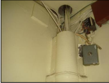
Photo N° 5933 AMIANTE CIMENT -- PALIERS +1 à +4 Gaines & coffres verticaux Fourreau
