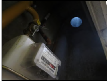
Photo N° 344 AMIANTE CIMENT -- GAINE TECHNIQUE 4 Gainses & coffres horizontaux Ventilation haute (Fibres-ciment)
