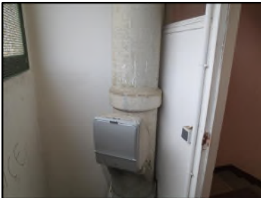
Photo N° 341 AMIANTE CIMENT PALIER VOLEE ESCALIER +1 Vide- ordures Gaine V.O.(Fibres-ciment)
