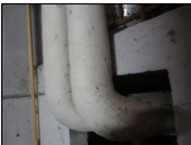
Photo N° 414 ECH-N°2 CALORIFUGEAGE --LOCAL CHAUFFERIE Conduits de fluide Laine minérale + enveloppe plâtrée
