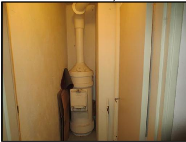
Photo N° 376 AMIANTE CIMENT -- LOCAL VIDE ORDURE 1 Vide- ordures Gain V.O.(Fibres-ciment)
