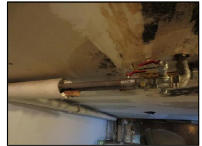
Photo N° 413 ECH-N°1 CALORIFUGEAGE --LOCAL CHAUFFERIE Conduits de fluide Liège + plâtre
