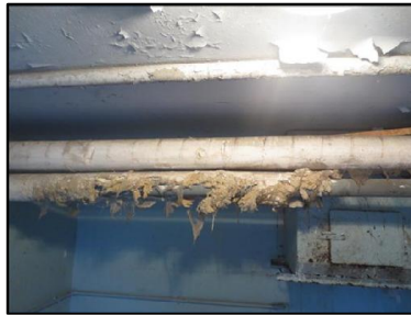
Photo N° 410 ECH-N°3 CALORIFUGEAGE --LOCAL POUBELLE Conduits de fluide Laine minérale + enveloppe plâtrée
