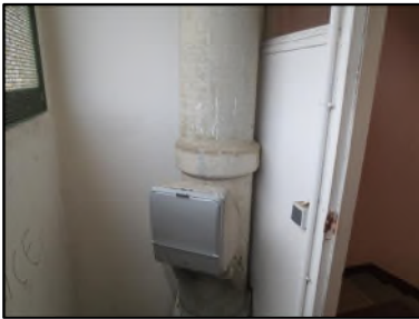
Photo N° 341 AMIANTE CIMENT PALIER VOLEE ESCALIER +1 Vide- ordures Gaine V.O.(Fibres-ciment)
