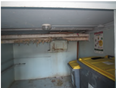
Photo N° 347 ECH-N°3 CALORIFUGEAGE LOCAL POUBELLE Conduits de fluide Laine minérale + enveloppe plâtrée
