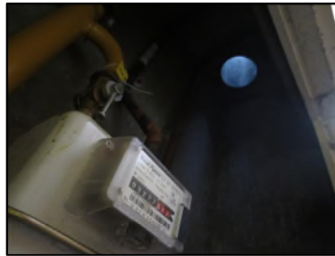
Photo N° 344 AMIANTE CIMENT -- GAINE TECHNIQUE 4 Gainses & coffres horizontaux Ventilation haute (Fibres-ciment)
