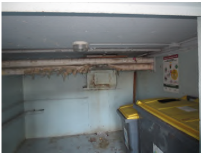
Photo N° 347 ECH-N°3 CALORIFUGEAGE LOCAL POUBELLE Conduits de fluide Laine minérale + enveloppe plâtrée
