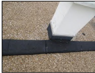
Photo N° 416 ECH-N°1 Toiture Murs Revêtement goudronné d'étanchéité
