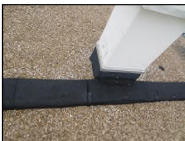
Photo N° 416 ECH-N°1 Toiture Murs Revêtement goudronné d'étanchéité
