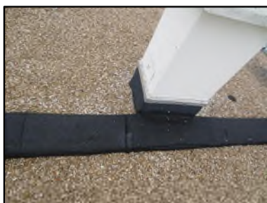
Photo N° 416 ECH-N°1 Toiture Murs Revêtement goudronné d'étanchéité
