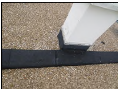
Photo N° 416 ECH-N°1 Toiture Murs Revêtement goudronné d'étanchéité
