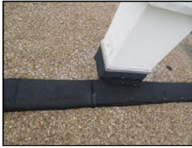
Photo N° 416 ECH-N°1 Toiture Murs Revêtement goudronné d'étanchéité
