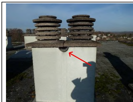
Photo n° Ph11 Localisation : Toiture - Terrasse Ouvrage : Conduits, canalisations et accessoires intérieurs et extérieurs - Conduits de vapeur, fumée, échappement Partie d'ouvrage : Conduit Description : 4 canalisation évacuation des cheminées
