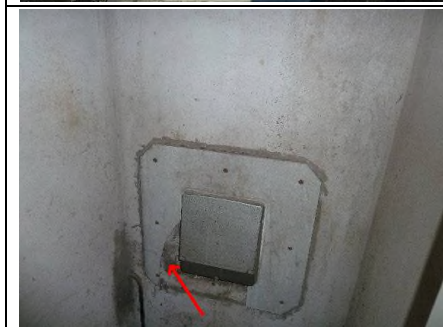
Photo n° Ph012 Localisation : Étage 1 - Local poubelle Ouvrage : Vide-ordure Partie d'ouvrage : Plaque de protection Description : Plaque en fibre ciment
