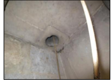
Photo N° 970 AMIANTE CIMENT -- PLACARDS GAZ +4 Plafonds Ventilation haute (Fibres-ciment)
