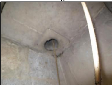
Photo N° 970 AMIANTE CIMENT -- PLACARDS GAZ +4 Plafonds Ventilation haute (Fibres-ciment)
