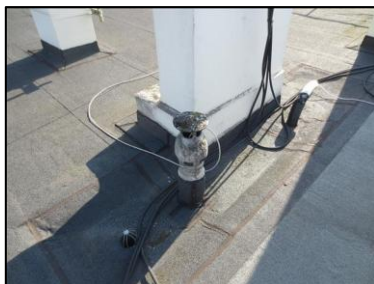
Photo N° 969 AMIANTE CIMENT -- TOITURE Toiture Chapeau (Fibres- ciment) x2
