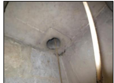
Photo N° 970 AMIANTE CIMENT -- PLACARDS GAZ +4 Plafonds Ventilation haute (Fibres-ciment)
