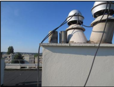
Photo N° 968 AMIANTE CIMENT -- TOITURE Conduits de fumée Cheminée (Fibres-ciment)
