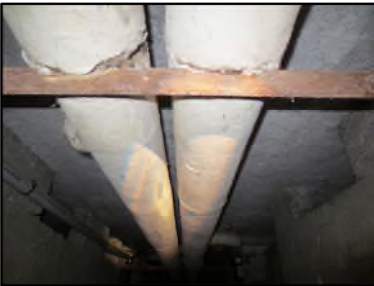
Photo N° 106 ECH-N°2 CALORIFUGEAGE --Sous Sol Conduits de fluide Laine minérale + enveloppe plâtrée
