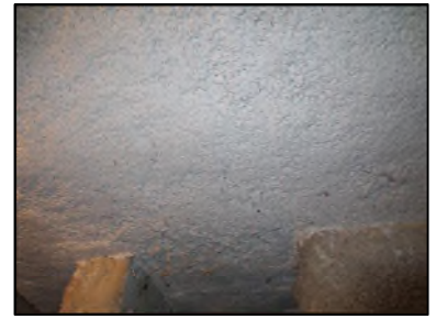
Photo N° 105 ECH-N°1 FLOCAGE Sous Sol Plafonds Cotonneux blanc
