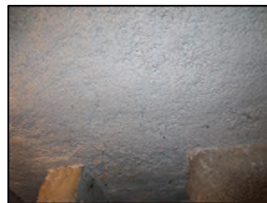
Photo N° 105 ECH-N°1 FLOCAGE Sous Sol Plafonds Cotonneux blanc
