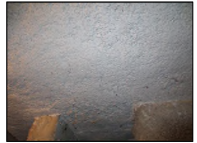
Photo N° 105 ECH-N°1 FLOCAGE Sous Sol Plafonds Cotonneux blanc
