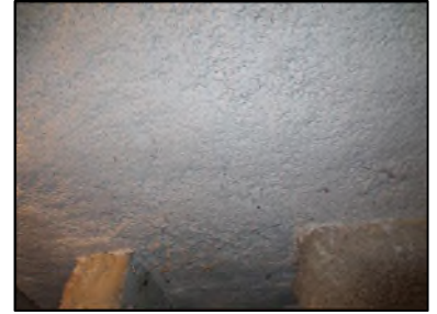
Photo N° 105 ECH-N°1 FLOCAGE Sous Sol Plafonds Cotonneux blanc
