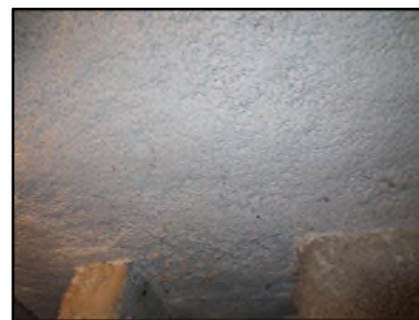
Photo N° 105 ECH-N°1 FLOCAGE Sous Sol Plafonds Cotonneux blanc
