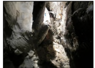
Photo N° 109 AMIANTE CIMENT Sous Sol Conduits Fourreau
